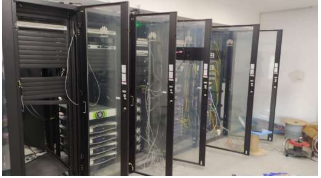
Yapım çalışması devam eden yeni Sistem Odası
